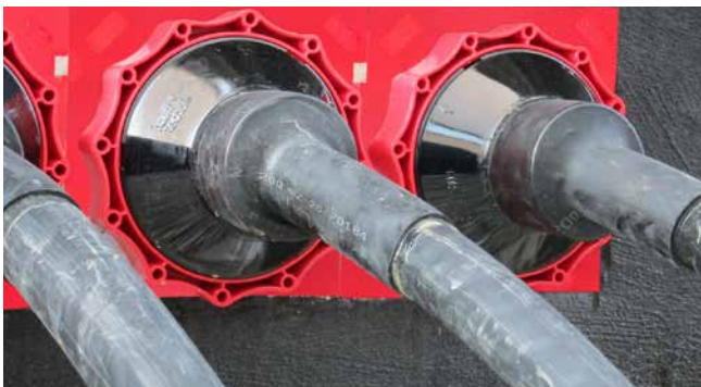
Stationseinführung: Niederspannungskabel abgedichtet mit HSI150 D1x80 WS
