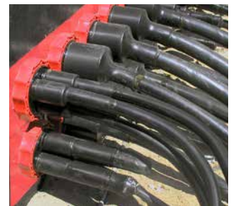
Stationseinführung: Niederspannungskabel abgedichtet mit HSI90 D1x75 WS und HSI90 D3x32 WS
