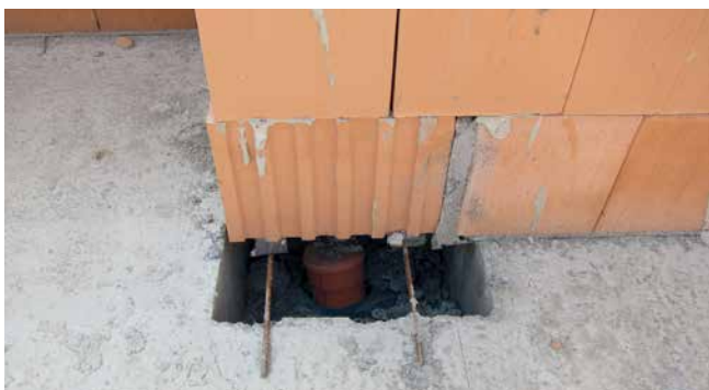
Schwierigkeit: nachträglicher gas- und dampfdichter Verschluss
